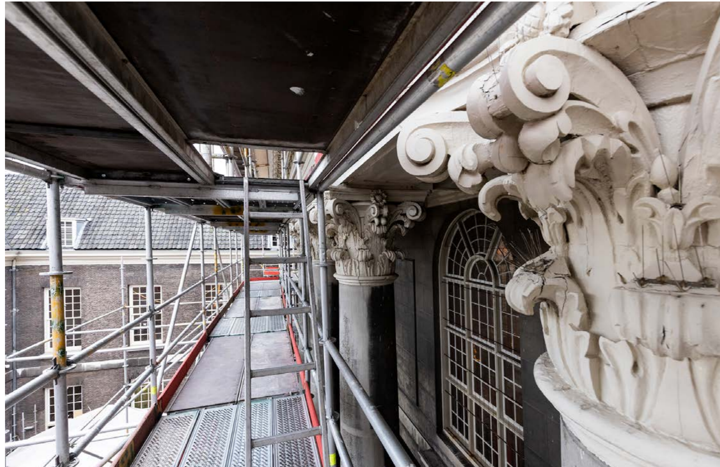
Renovatie van de gevel van het Sint Jacobs Gasthuis. Fotografie: Aad Hoogendoorn
